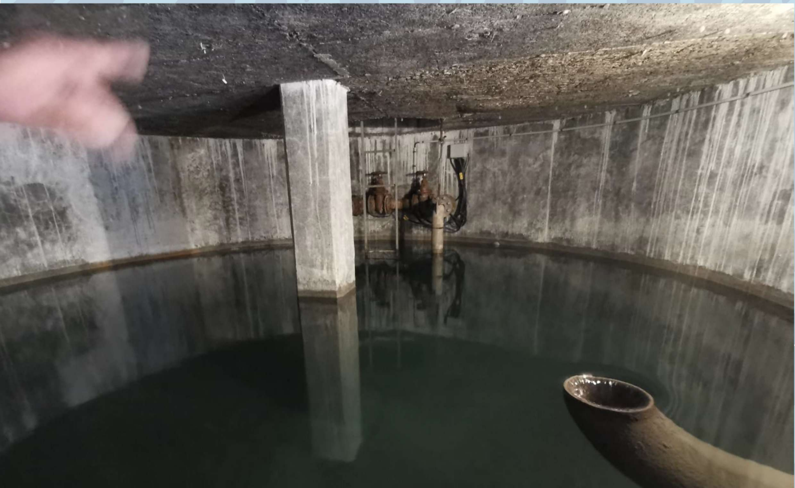
9 Bassin du réservoir secondaire
