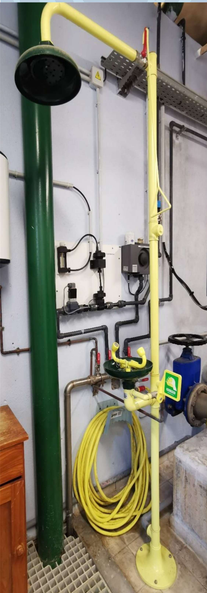
13 Douche de sécurité pour le personnel
