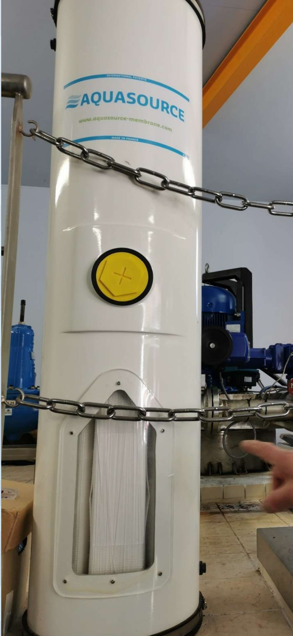
10 Aquasource, un matériel de traitement de l'eau
