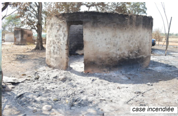
lutte contre l'incendie
